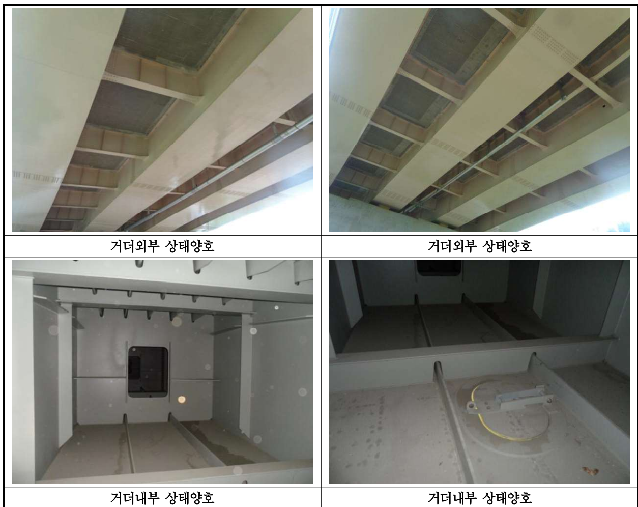
【사진 18.3.5】 거더 손상현황
